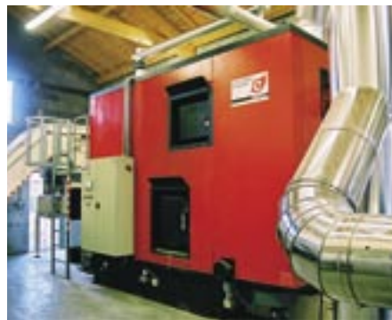
La chaudière automatique
