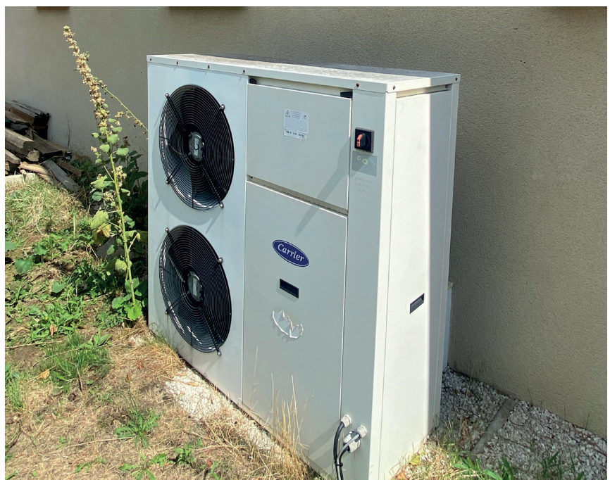
Pompe à chaleur
